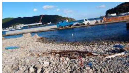
地盤沈下で水没する岸壁～女川漁港
